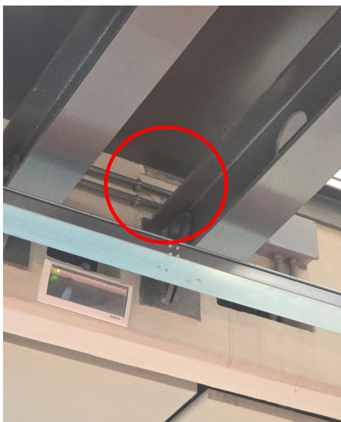
Distacco localizzato sulla trave adiacente agli ascensori panoramici.
