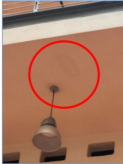
Ulteriore area con alterazioni visibili dell'intonaco.
