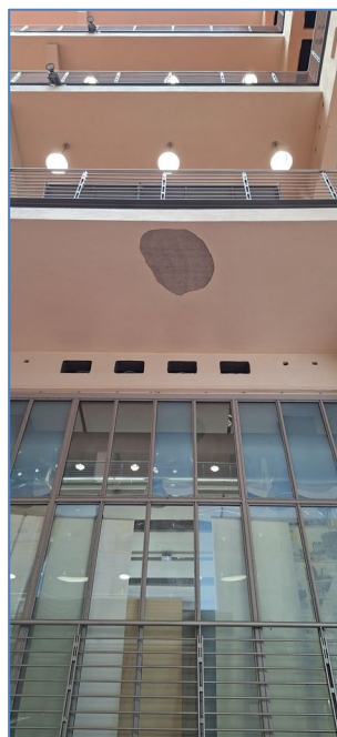
Porzione di intonaco distaccata dall'intradosso della balconata.
