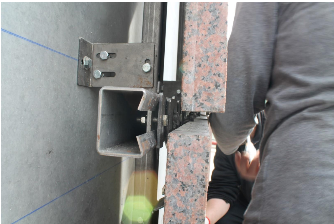
Figura 40. Allentamento viti su traverso superiore (fase 2)
